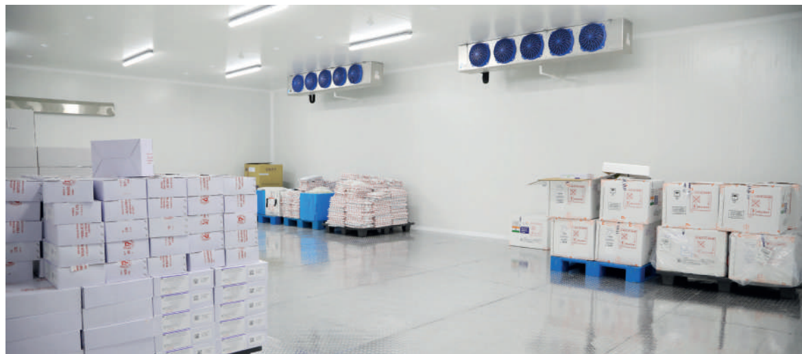
Cuarto refrigerado bodega de medicamentos Zona 13
