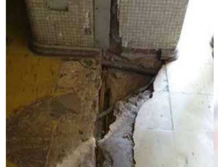
Juntas sísmicas selladas que no pudieron trabajar adecuadamente durante el terremoto del 2010 en un hospital de la Región VI de Chile.
