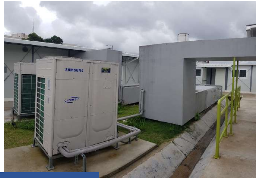
Gases medicinales, aire acondicionado. Señales débiles, voz y datos
