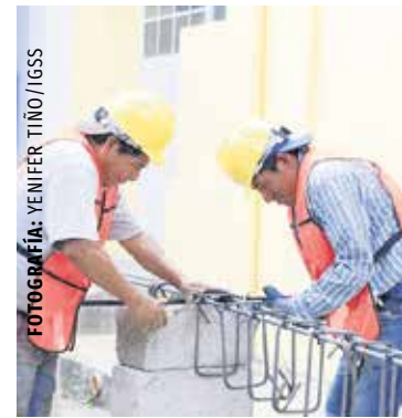
"La Capitanía" se ubica en la 6ta. avenida final norte, finca El Manchén, a un costado de clínicas Panchoy, cuya área de construcción es de 3 mil 081.76 metros cuadrados.
